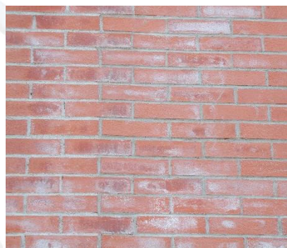
parete in mattoni faccia vista con efflorescenze in atto; un trattamento con Pulicem Gel sarà risolutivo
